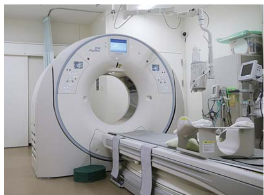
▲導入したエックス線CT診断装置
